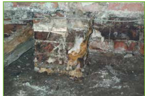
Desarrollo de moho, hongos y estructura dañado del edificio
