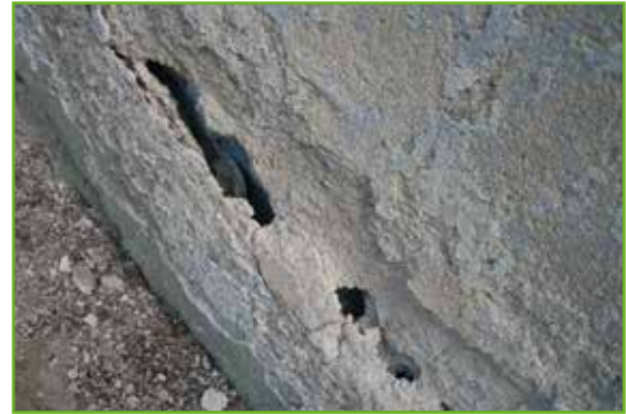
Desprendimiento de yeso
